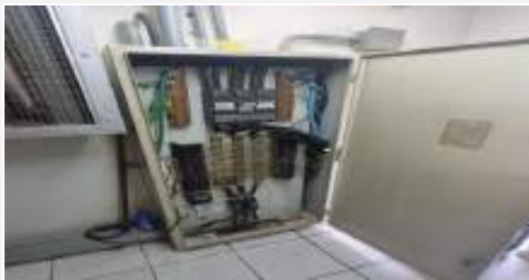
QUADRO DE ENERGIA EXISTENTE
