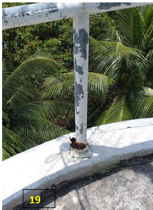
Figura 19 - Corrosão em guarda corpo
