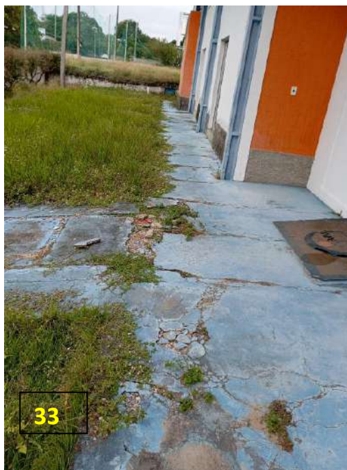
Figura 33 - Estado atual da calçada principal do Epsilon, apresentando placas do piso soltando devido as trincas.
